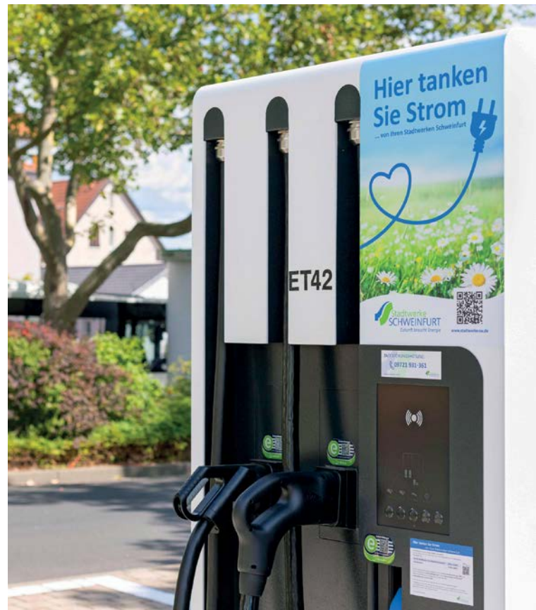
Einer der über 90 Ladepunkte der Stadtwerke Schweinfurt
